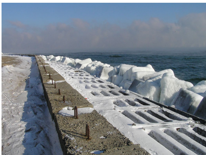
Рис. 2.1. Обледеніння берегозахисної споруди в районі Лузанівки (м. Одеса)
